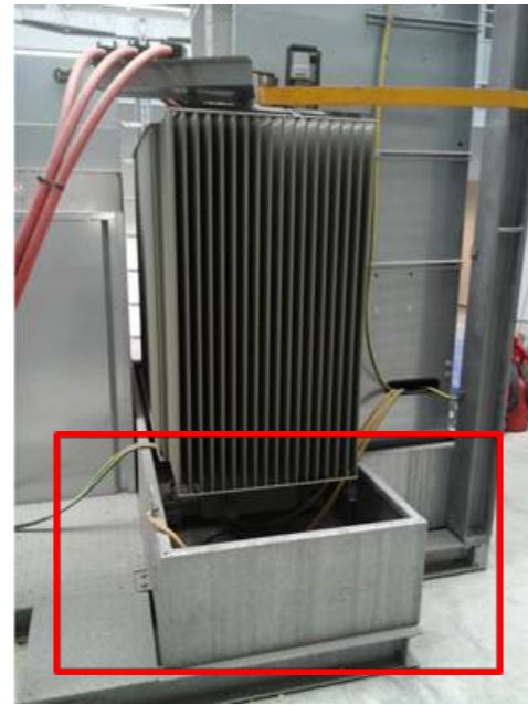
Figure : Bac de rétention du transformateur
