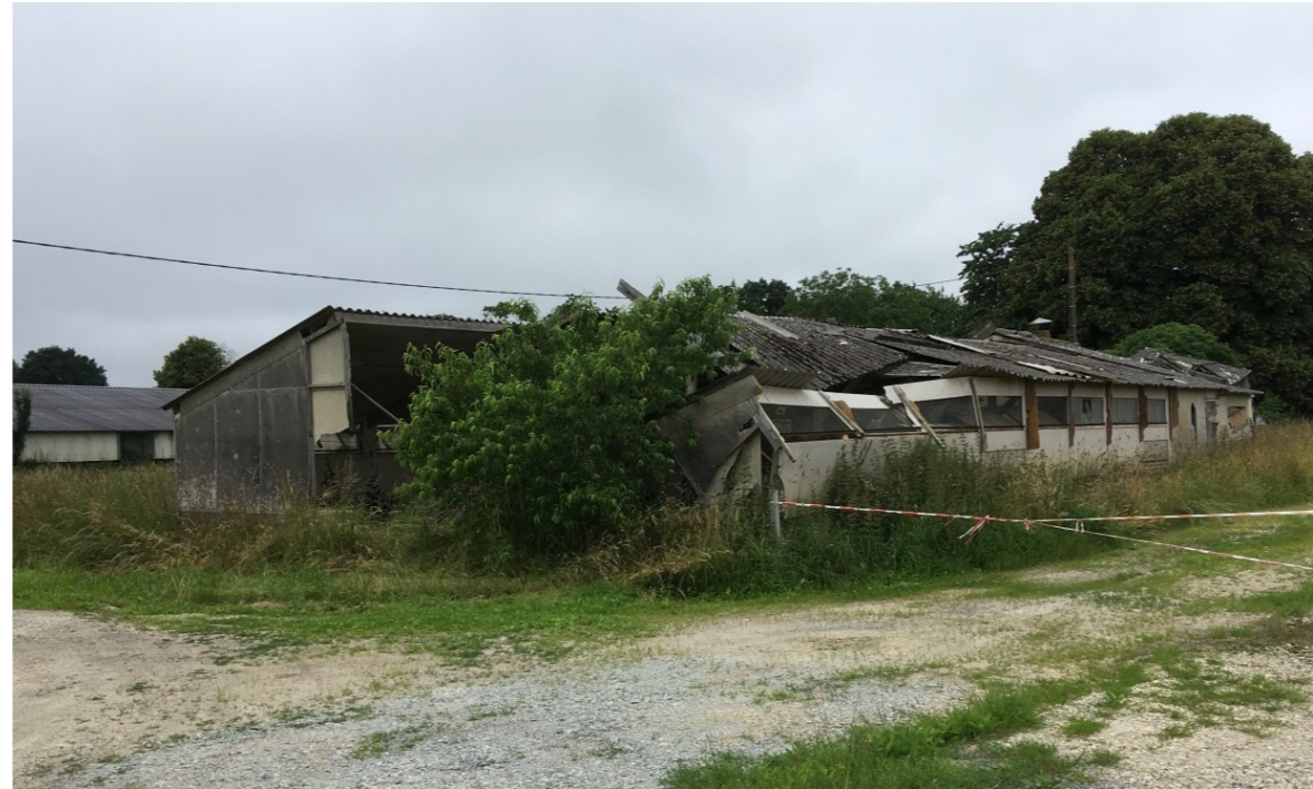
Photo : Ancien poulailler en ruine (béton et couverture amiante)
